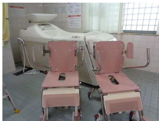
機械浴槽およびシャワーキャリア
